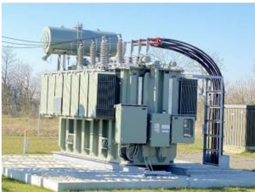
Figur 3-15. Eksempel på forsyningstransformer. Kilde: Ecosolar.
